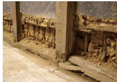
白蟻被害の例 床壁
