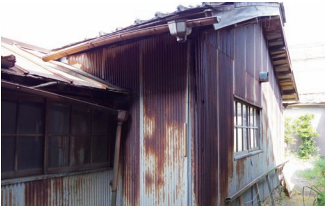
縦樋が外れている
