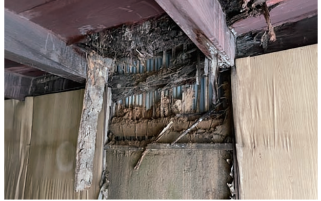
屋根から内部まで漏水し木材が腐食
