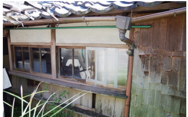
集水器が外れかかっている
