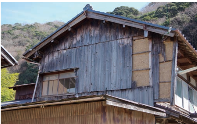
外壁がめくれ土壁が露出している
