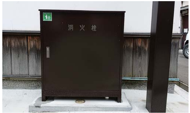
消火栓（易操作性）
